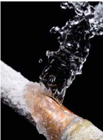
Die Bildung von Eis kann Rohrleitungen unter zu starke Belastungen setzen.
