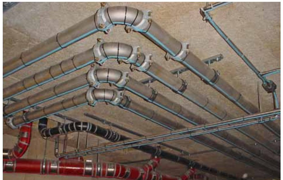
Beispiel aus dem gewerblichen Bereich: Begleitheizbänder sorgen für Frostschutz und Temperaturhaltung im Verwaltungsgebäude einer Supermarktkette.
